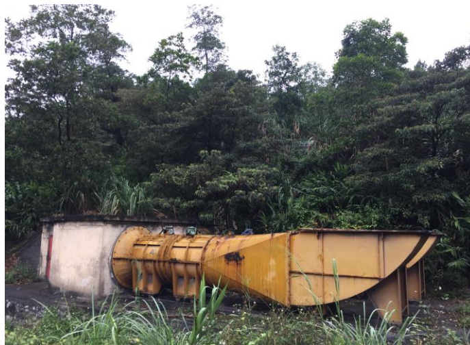
Hình 1. Hình dáng trạm quạt gió chính khu vực mỏ Cao Thắng.
